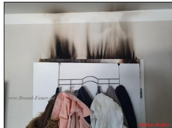
Abbildung 17 Hinter der Tür in Sicherheit
